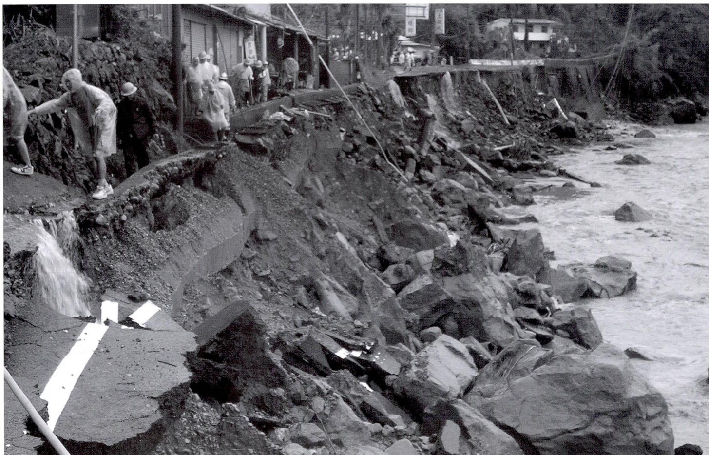
◆七二水災後，中橫公路十公里處的馬鞍寮附近路基被大水沖毀，景象滿目瘡痍。
