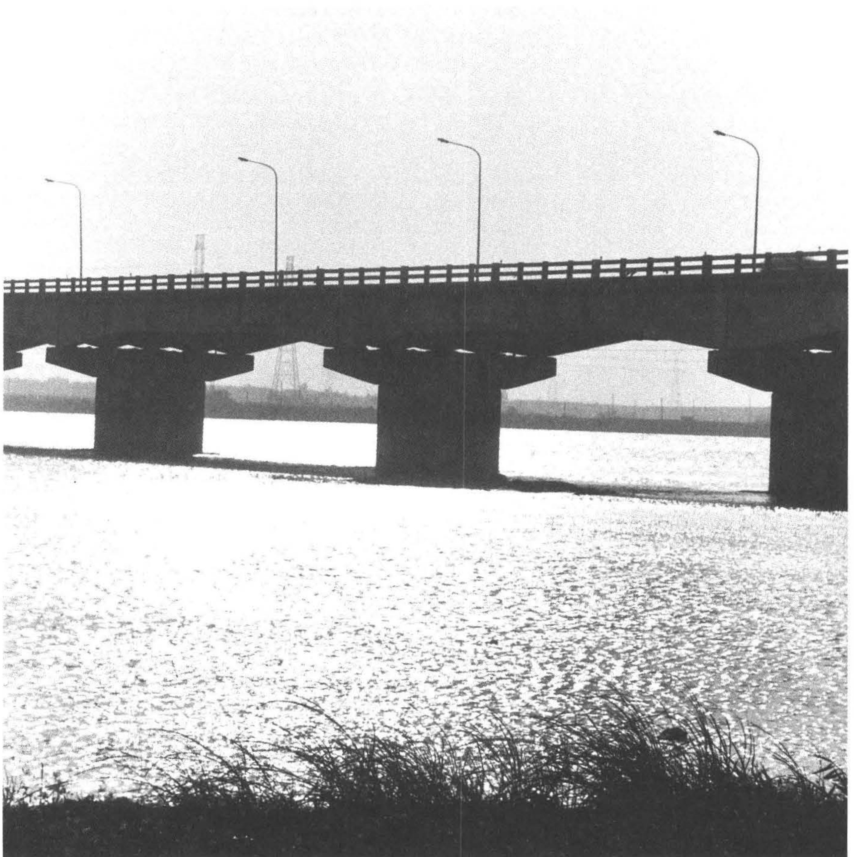
◆中彰大橋是台中縣 龍井鄉與彰化縣伸港 鄉重要聯絡橋樑。 (攝於台中縣龍井鄉)
