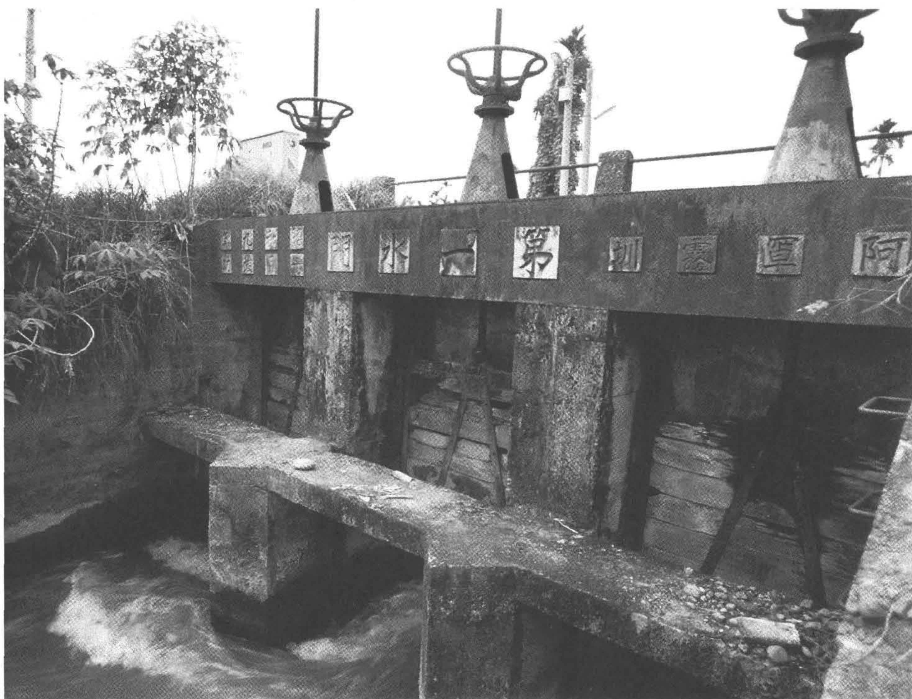
◆「阿罩霧圳」引水口位於霧峰通往草屯的烏溪橋上方約一公里處；「阿罩霧圳」第一分閘門築於日治昭和九年。（攝於台中縣霧峰鄉）
